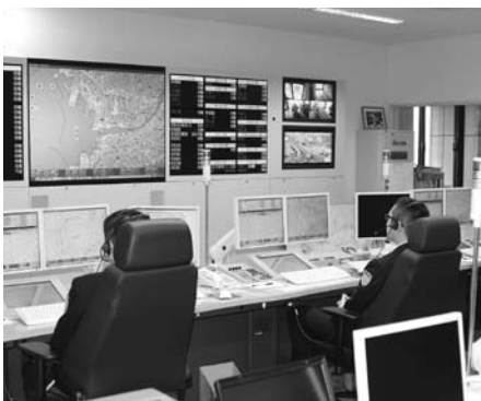
消防本部通信司令室
