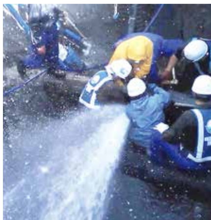
▲老朽水道管破損の様子
