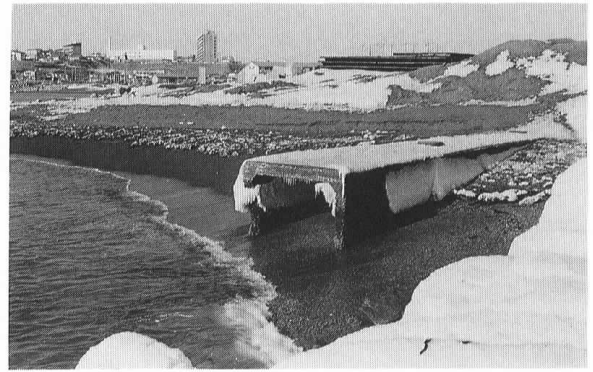
カルバートの閉塞状態
