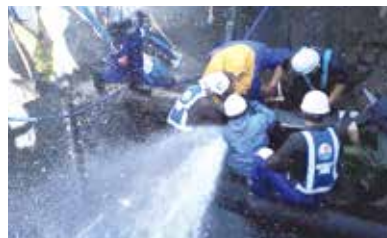
▲老朽化による水道管の漏水
