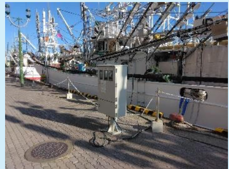
写真8：陸上電源供給施設 (釧路フィッシャーマンズワークスMOO前)
