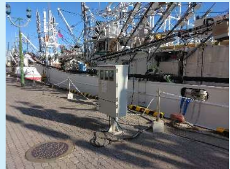
写真8：陸上電源供給施設 (釧路フィッシャーマンズワーフMOO前)
