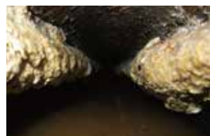
▲下水管内で固まった油
