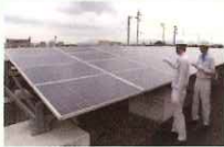
太陽発電設備の検査の様子
