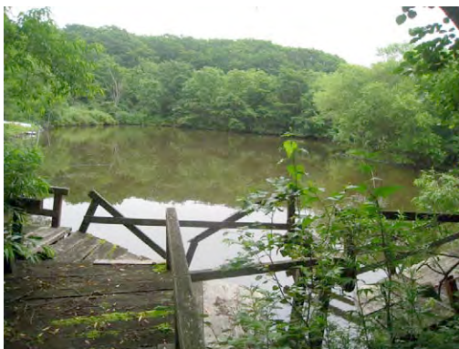
破損している施設（デッキ）
