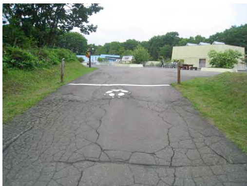
破損がみられる舗装
