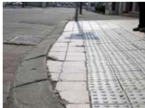
▲ 市役所から北大通へ行く特定経路 E の交差点 タイルが割れて波打っている
