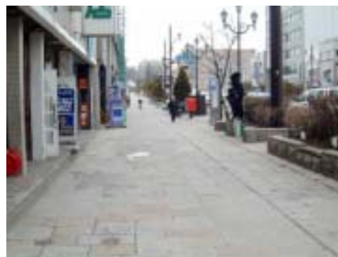
▲ 北大通 ブロックが波打ち凹凸や隙間ができています
