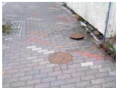
▲ 飛び出したマンホール
