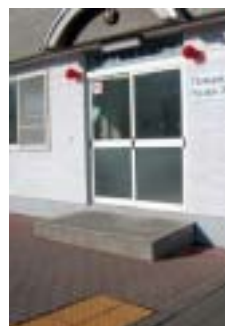
▲ 交番の入口にある段差
