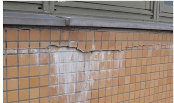
外壁タイルがひび割れて剥落の危険があり、白華も見られる。
