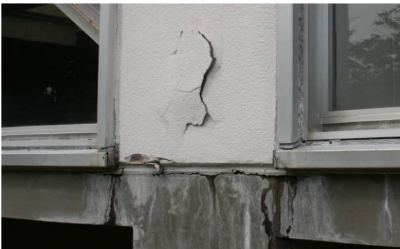
外壁に大きな浮きが見られ、剥落の危険がある。
