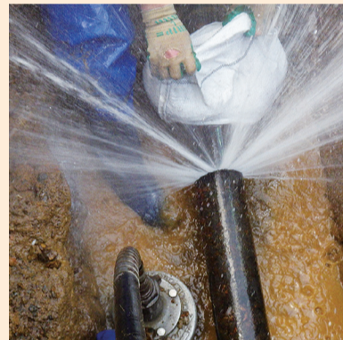
▲老朽管路の破損
