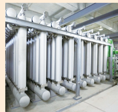
▲愛国浄水場に新たに導入するセラミック膜ろ過装置
