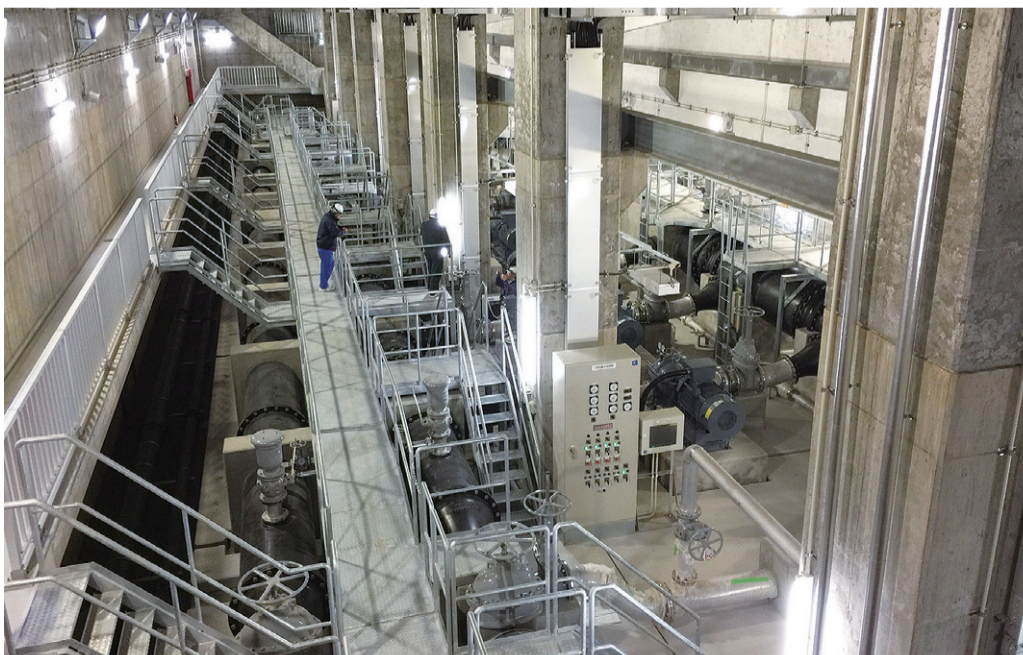
▲新送配水ポンプ場ポンプ室内
