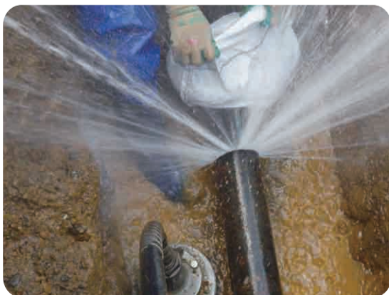
▲水道管から水があふれ出す状況①
