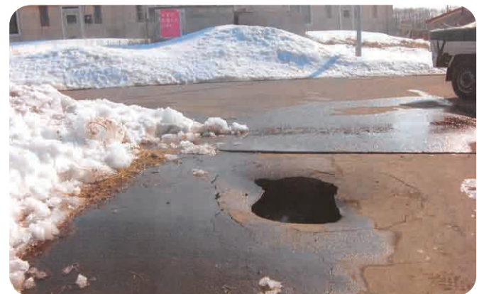
▲水道管から水があふれ出したことによる道路の陥没状況
