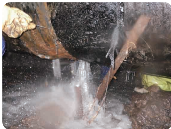
▲水道管から水があふれ出す状況②
