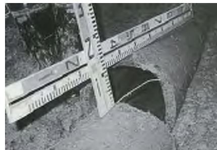
破損した管きよ
