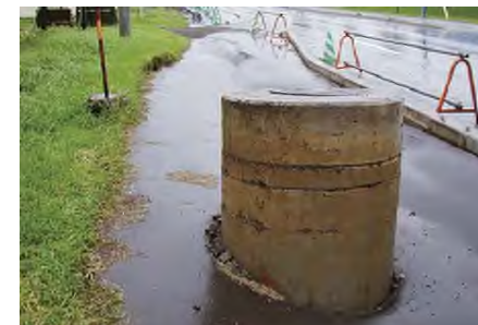
液状化による突出マンホール
