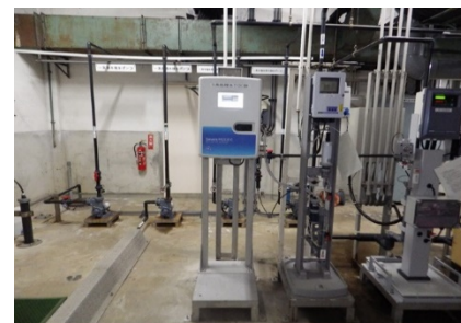
沈殿処理水 TOC 計
