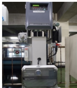
ろ過水濁度計
