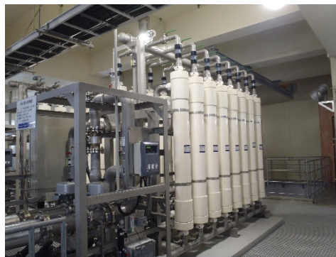
阿寒湖畔浄水場膜ろ過装置
