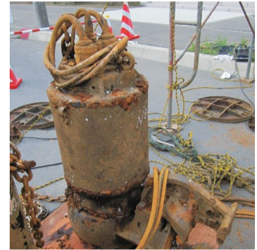
老朽化したポンプ設備
