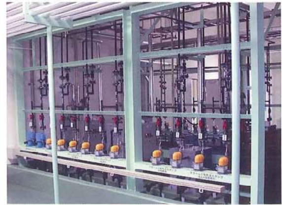
浸出水を処理するために凝集剤 (PAC)、PH調整剤 (苛性ソーダ、硫酸)、凝集助剤 (ポリマー)、スケール分散剤を注入する設備です。
