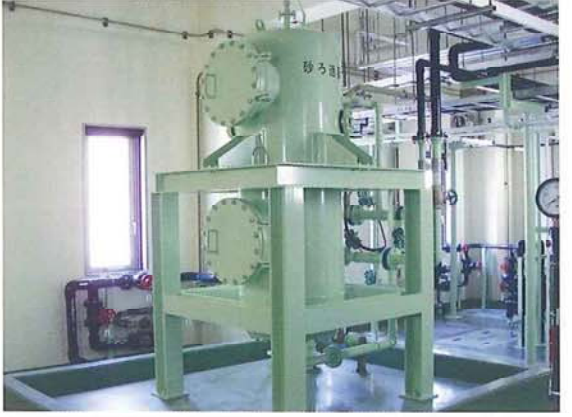
凝集沈殿後の処理水に残留するSS、CODを砂ろ過器で除却を行う設備です。
