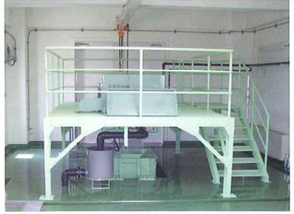
凝集沈殿後の汚泥を脱水し、ケーキホッパーに溜め、その後埋立て地に搬出する。
