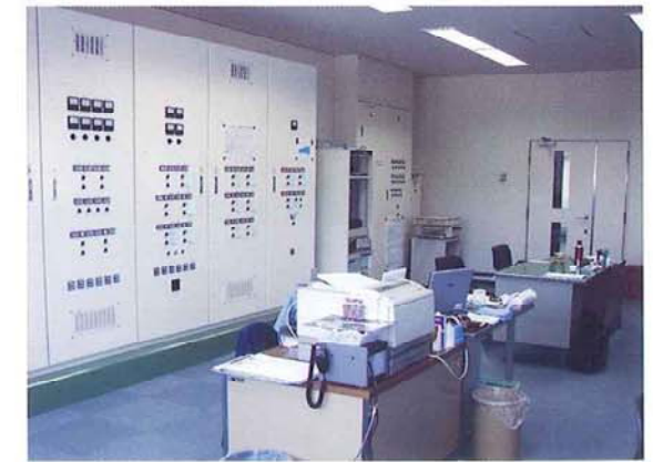
動力制御盤・監視盤により処理システム全体の運転状況を監視・制御する設備です。
