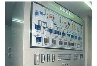
中央制御室 監視盤により処理システム全体の運転状況を制御・監視する設備です。
