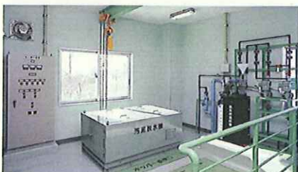
汚泥処理設備(汚泥脱水機)
