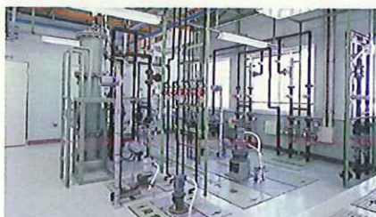
凝集沈殿処理設備(汚泥掻き寄せ機)
