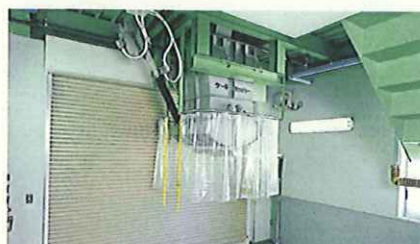
汚泥処理設備(ケーキホッパー)
