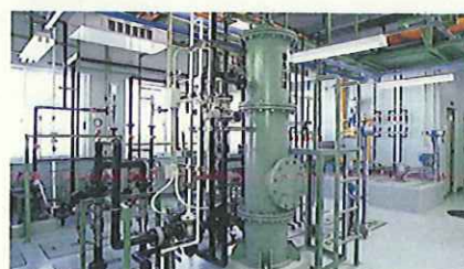
高度処理設備(砂ろ過器)
