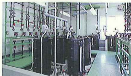
薬品注入設備
