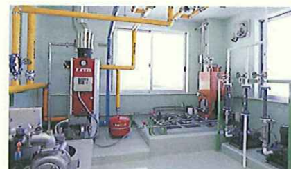
ボイラー直轄ブロー室
