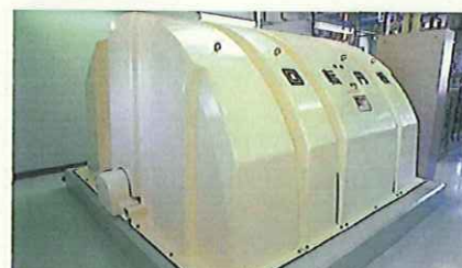
生物処理設備(回転円板)
