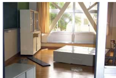
事例2: 耐震補強をしていたため建物には被害がありませんが部屋の中はごらんの通り
