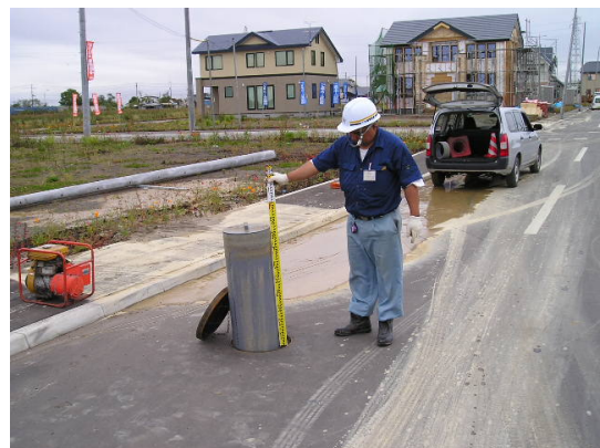
(平成 15年 十勝沖地震) 液状化によるマンホール突出被害
