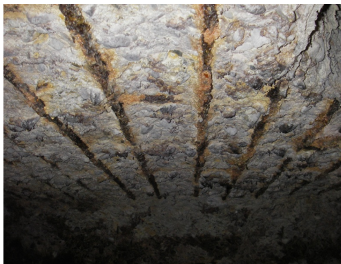
腐食により鉄筋が露出した状況
