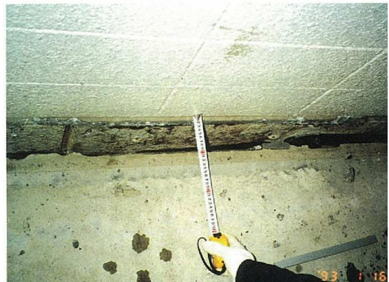
(平成 5年 釧路沖地震) 予備曝気棟と水処理棟の隙間発生
