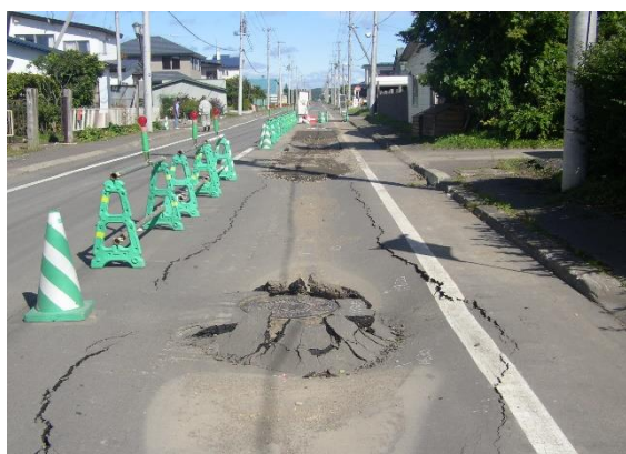
(2003年(平成15年)十勝沖地震) 管路部の液状化による陥没被害
