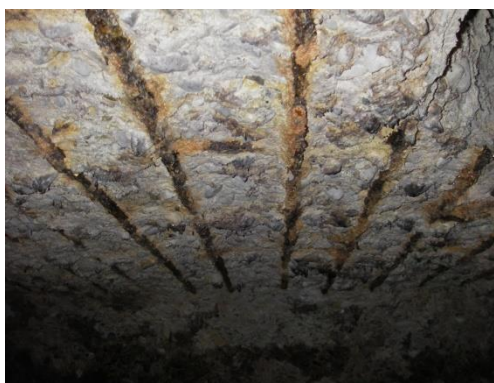
腐食により鉄筋が露出した状況
