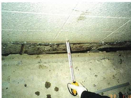
(1993年(平成5年)釧路沖地震) 予備曝気棟と水処理棟の隙間発生
