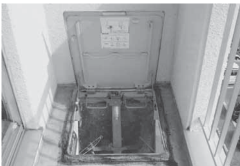
交換が求められている避難用ハッチ（美原市営住宅）
