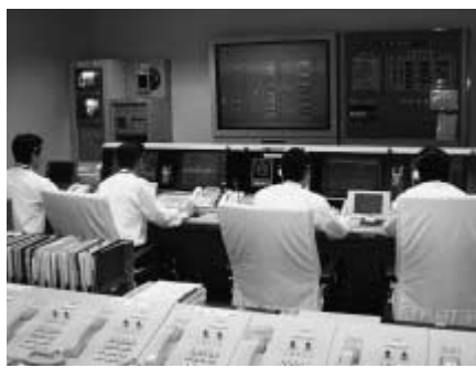
消防本部の緊急消防指令施設
