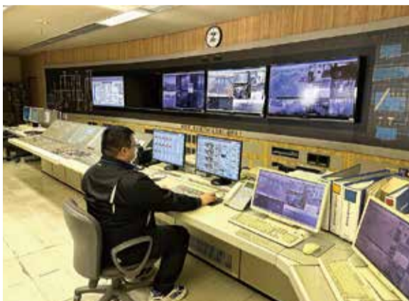
▲中央監視室で場内の機械を管理しています。
