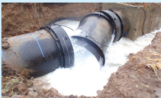
地震でつなぎ目が抜けた水道管(漏水の様子)
