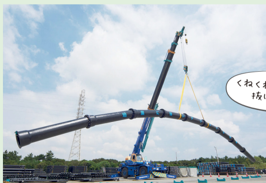
耐震化された水道管
