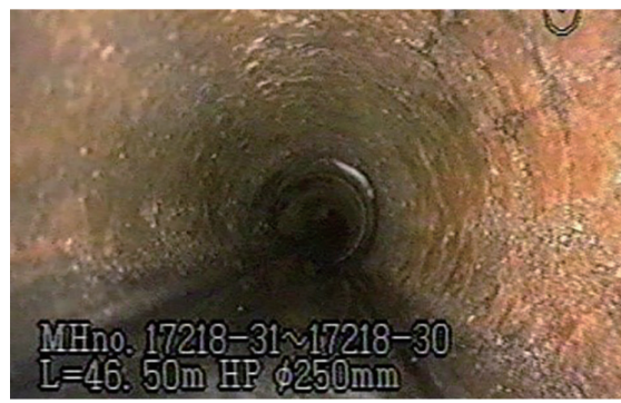
老朽化した下水道管の内部
