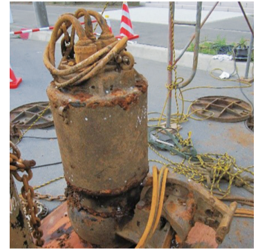
老朽化したポンプ設備
